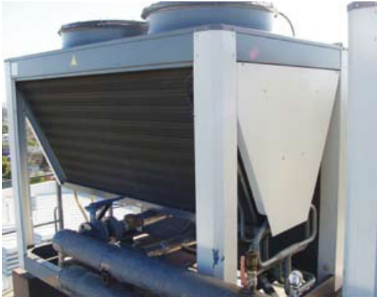
La bomba de calor extrae la energía térmica del aire y luego de un proceso, permite calefaccionar las viviendas.
